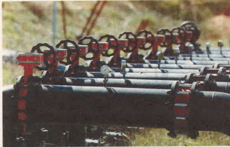
Instalaciones de bombeo. / R.S.
