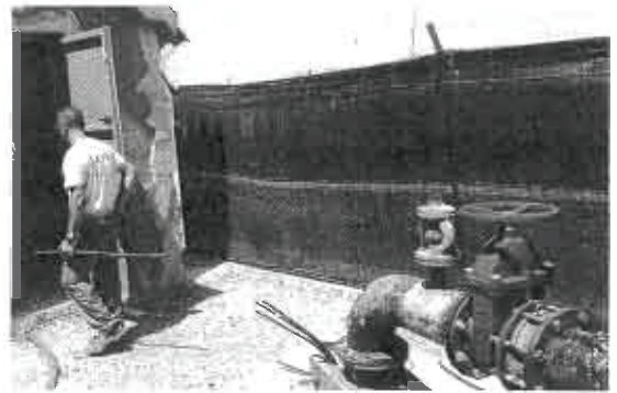
Uno de los pozos que forman parte de la BES. J.C.H.
