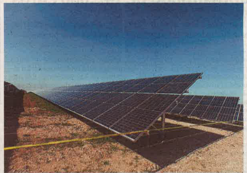
Planta solar fotovoltaica. / Y.L.
