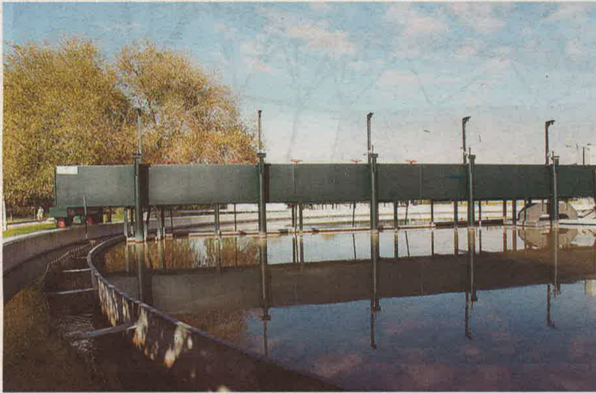
Instalaciones de la Estación Depuradora de Aguas Residuales de Albacete. / A.P.
