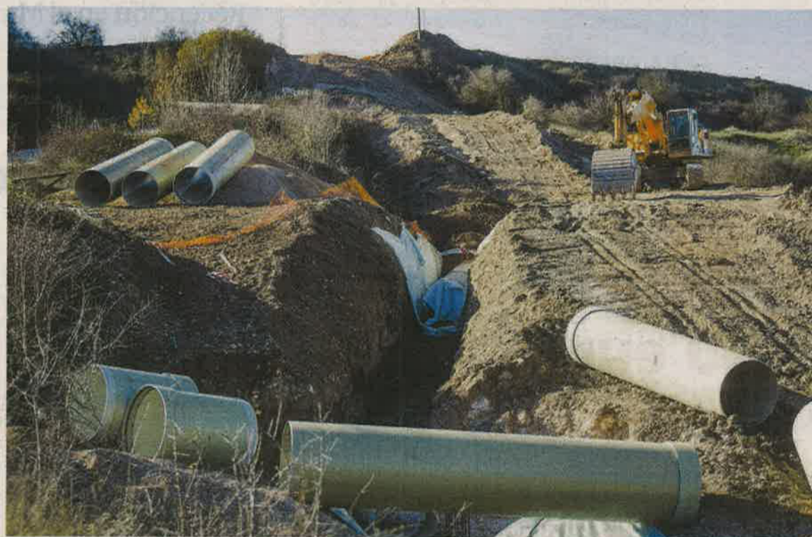
Imagen de archivo de obras de extensión de una conducción de agua potable. / LUIS LÓPEZ ARAICO
