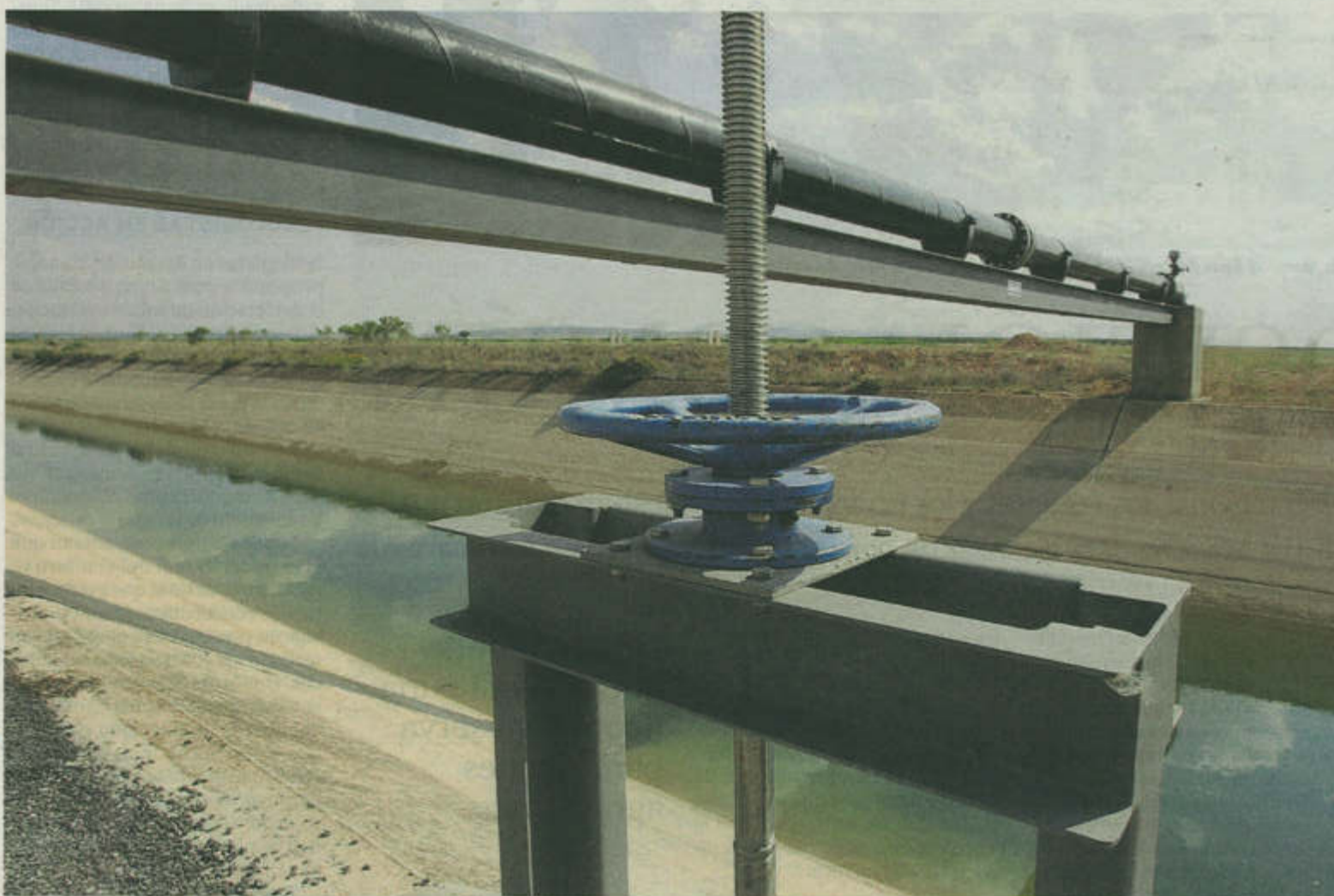
Una de las tomas de la sustitución de bombeos de la Mancha Oriental pasa sobre el acueducto del Traslase Tajo-Segura. / ARTURO PÉREZ
